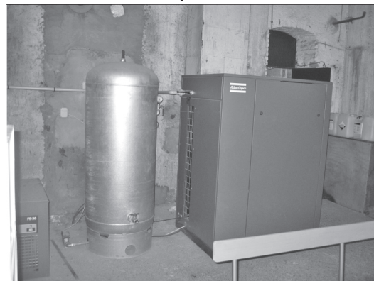
Centrale de production d'air comprimé médical
