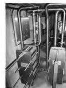
Thermes de Bagnols-les-bains (48) Réalisation Roussel Inox
