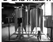
Usine d'embouteillage d'eau minérale (Géorgie) Réalisation T.T.I.A.G
